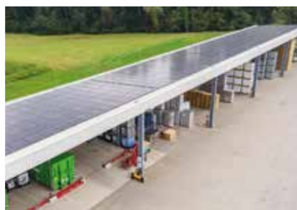
Photovoltaik auf Lager-Flachdach
