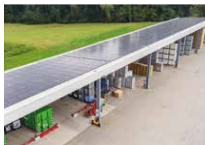
Photovoltaik auf Lager-Flachdach
